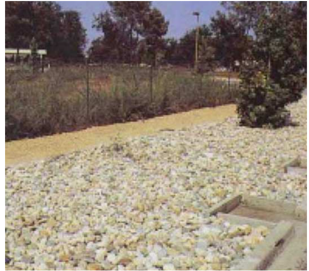
Figure 18 - Tranchée le long d'un trottoir de l'avenue de la Grande Lande à Gradignan, France
